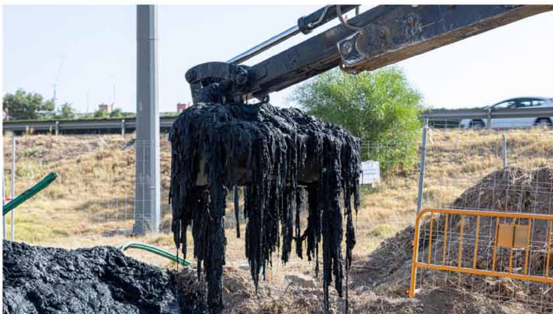
Toallitas húmedas extraídas de una red de saneamiento de EMASESA. Emasesa Sevilla
