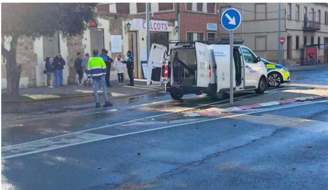
Reventón en la avenida de Lasalle
